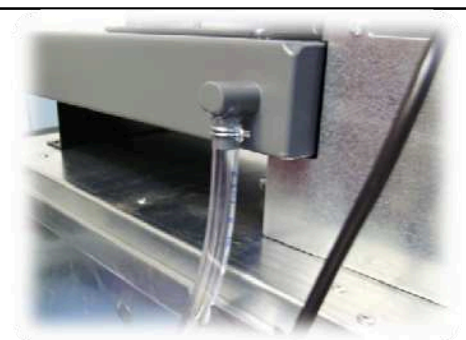
Le tuyau est bien fixé
